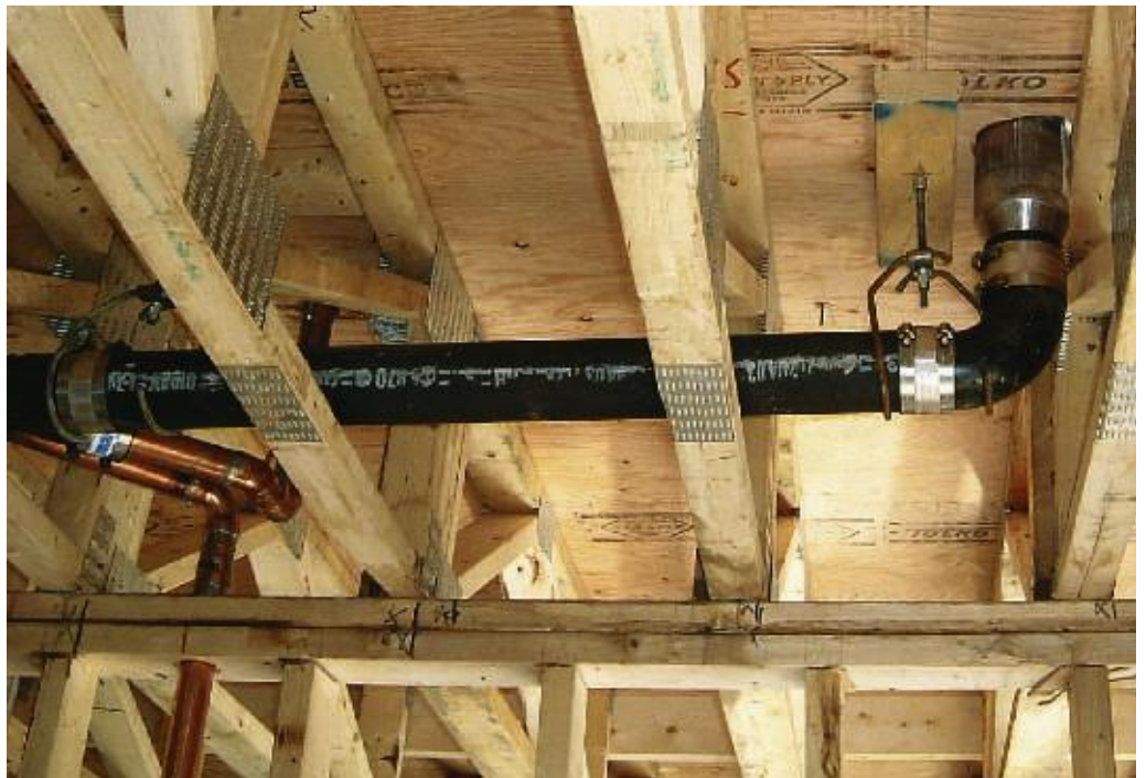
사진 10 바닥 중공을 관통하고 있는 난방 덕트 및 기타 설비. 배관, 난방, 전기 설비는 내부 간막이벽을 통해 층 사이에 쉽게 배치됩니다.
